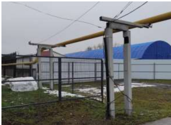
Рисунок 11. Газопровод низкого давления
