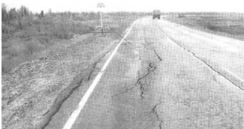
Рисунок. 3 Фотофиксация развития продольных трещин
