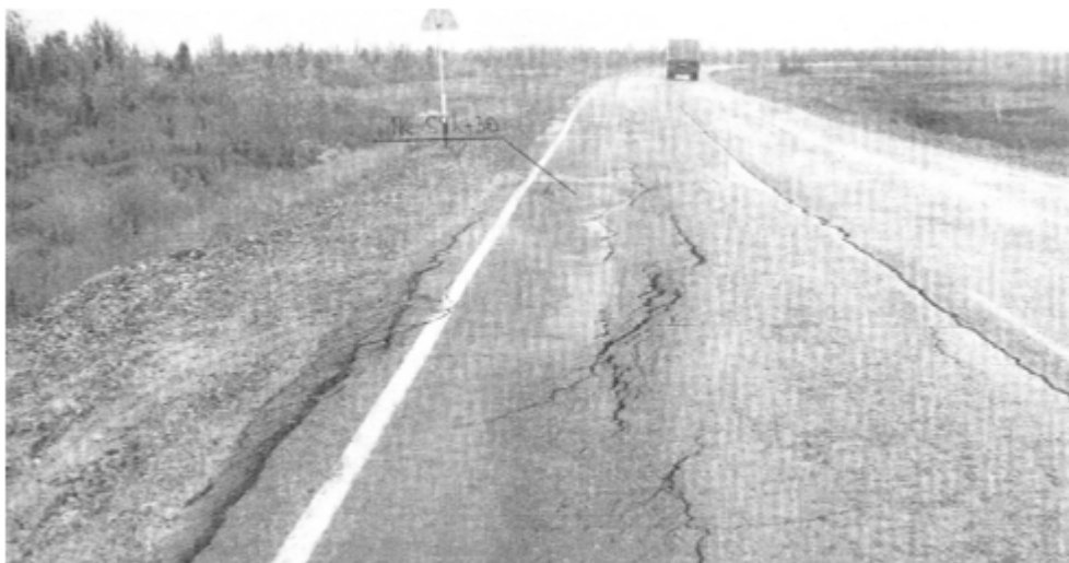
Рисунок. 3 Фотофиксация развития продольных трещин
